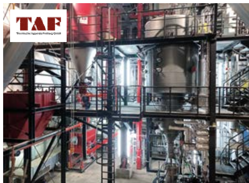
Zwei Jahre nach Projektstart wurde die Multi-Fuel-Conversion-Anlage im Juni 2021 planmäßig an RWE übergeben.
